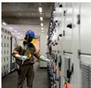
Acima, funcionário da Raízen monitora atividade de cogeração de energia. Ao lado, subestação de energia elétrica localizada em Barra Bonita
